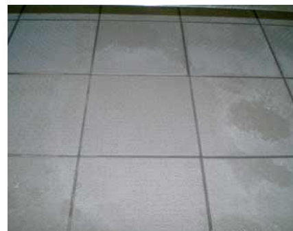
Schleierbildungen lassen sich bei Fugenmörteln auf Silikatbasis nur mit Reinigern entfernen, deren Rezeptur schon der Hersteller auf den Fliesenbelag abgestimmt hat, damit dieser nicht angegriffen wird.
