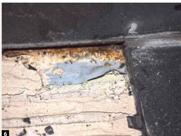
6 Schadensbild mit unsachgemäßer Abdichtung
